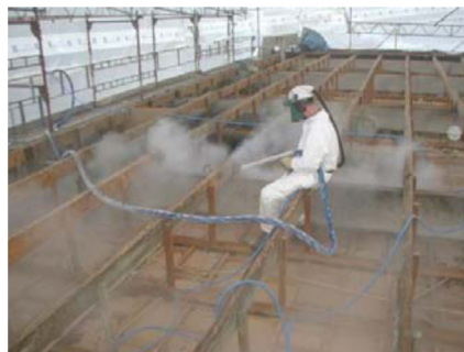
Tagkonstruktion afrensnes med isafrensning. Efterfølgende støvsuges tagkonstruktionen samt behandles forebyggende med Protoxskimmel.
