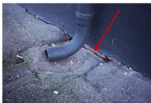
Revne mellem sokkel og asfaltbelægning skal lukkes med asfalt, gadesiden
